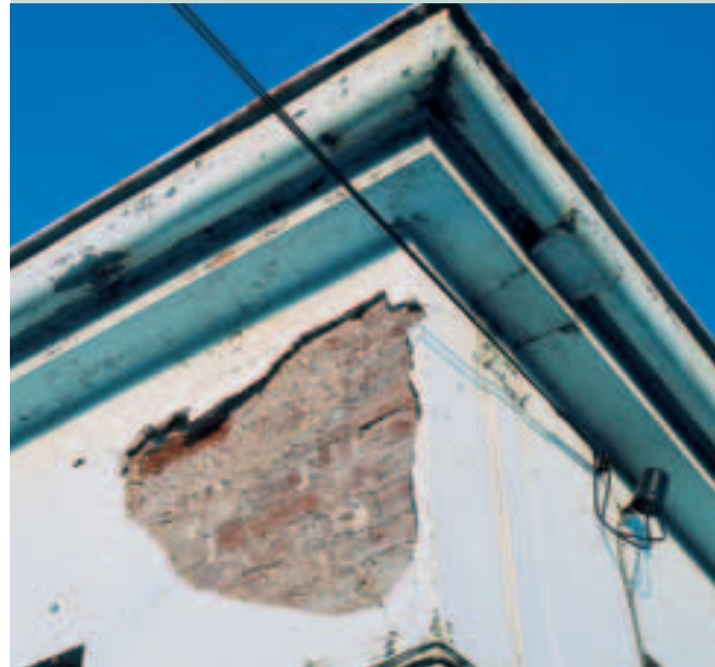
Влажность воздуха и заморозки приводят порой к разрушению оштукатуренных поверхностей
